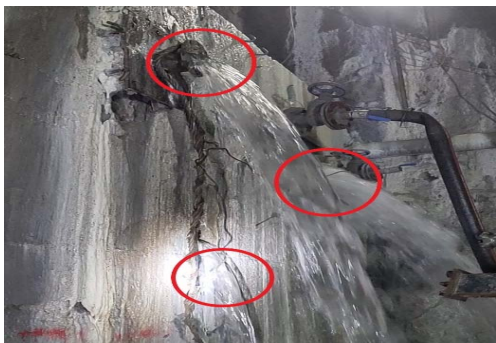
图7 桩号X2+172.9探水钻孔出水照片
