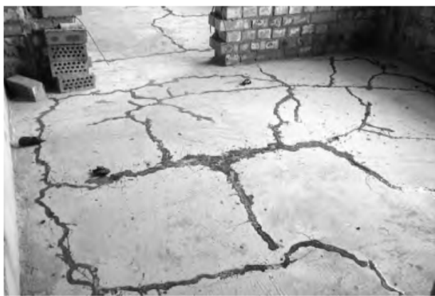
图2 干燥性收缩裂缝
