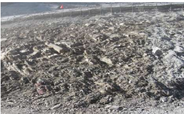
开挖后中、下部强倾倒的岩层 施工开挖揭露边坡岩层倾倒情况
