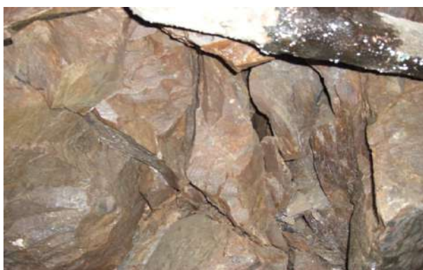
探洞 56m 处岩体拉裂架空(中部)
